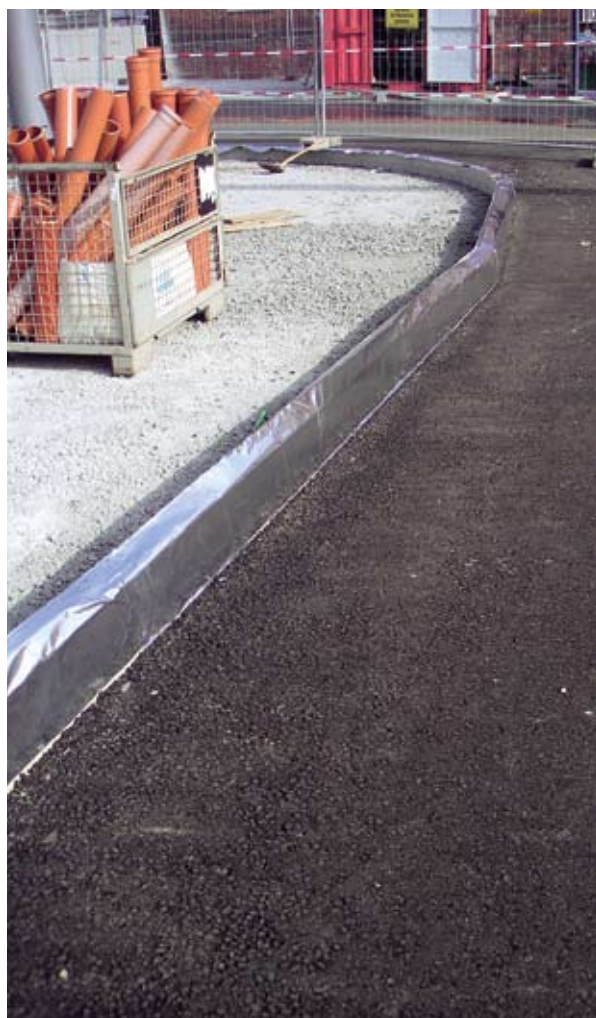
Aszfalt teherhordó ház letakart szegélyfolyókéval
