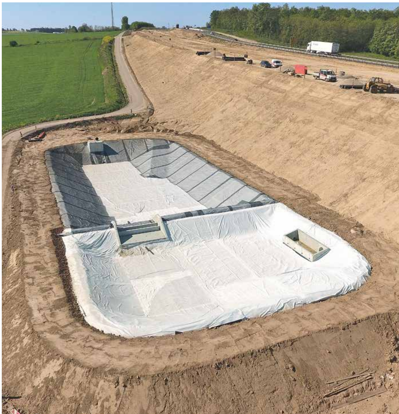
A teljes útvonalon 18 felszíni vízi védművet építettek, – ezeket folyamatos észleléssel ellenőrzik. A képen egy lépcsős, kétmedencés védmű látható.
