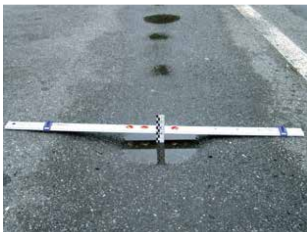
Deformálódott aszfaltpálya, nyomvályúkkal
