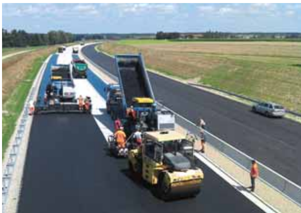
2. ábra: Jó tapadókapcsolat az aszfalt és beton között az A94 autópályán (Fotó: Firma Berger)
