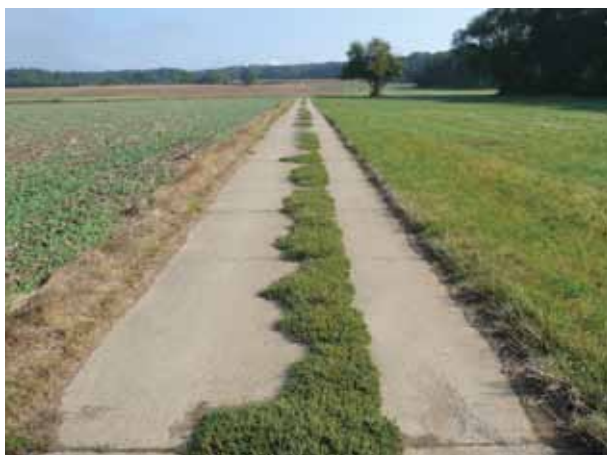
5 Hosszrepedés növényzettel beszőve
