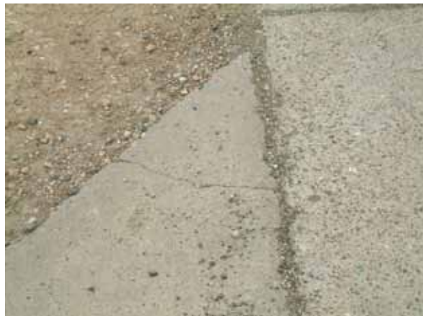
8 Hegyesszögű csúcs átrepedése
