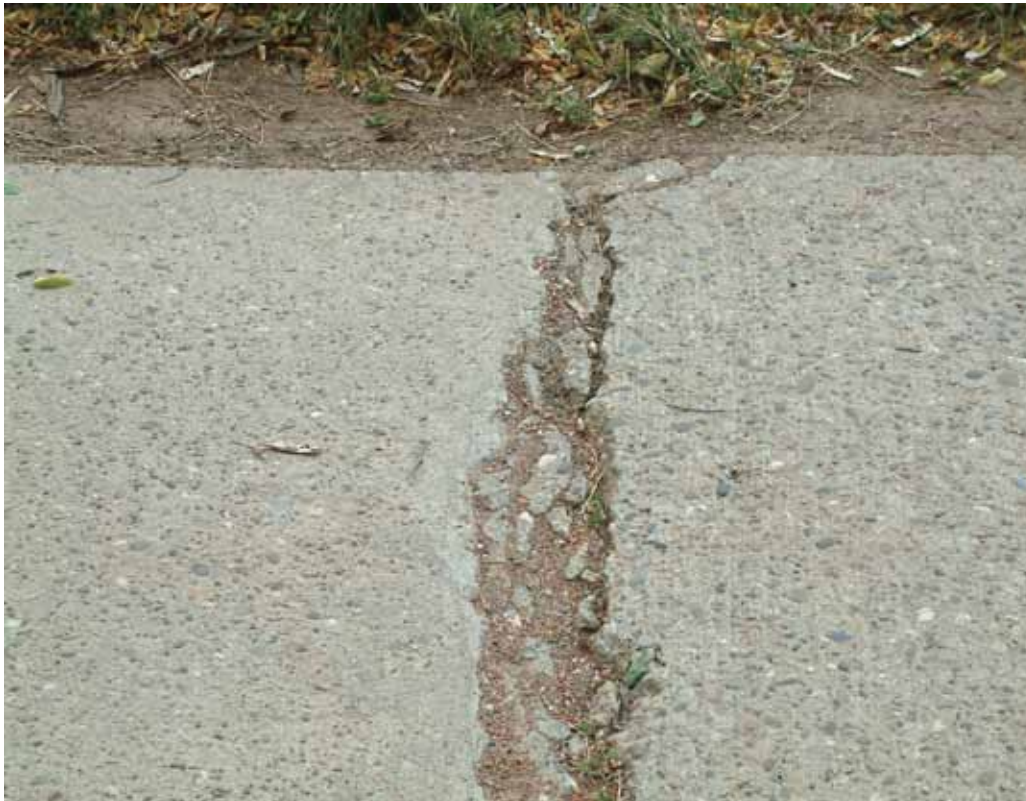
4 Éltörés a hézag elégtelen tömörítése miatt
