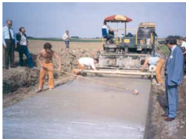
7. kép: Beépítés finiszerrel Fotó: Archiv ISTU, Inst. Verkehrswissenschaften, Professur für Strassen – u. Flugbetriebsflächen
